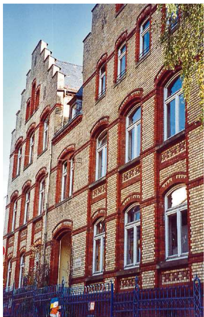
Die Philipp-Reis-Schule in Dotzheim: Derzeit wird hier wegen Feuchtigkeit saniert. Archivfoto: Rigobert Falk
