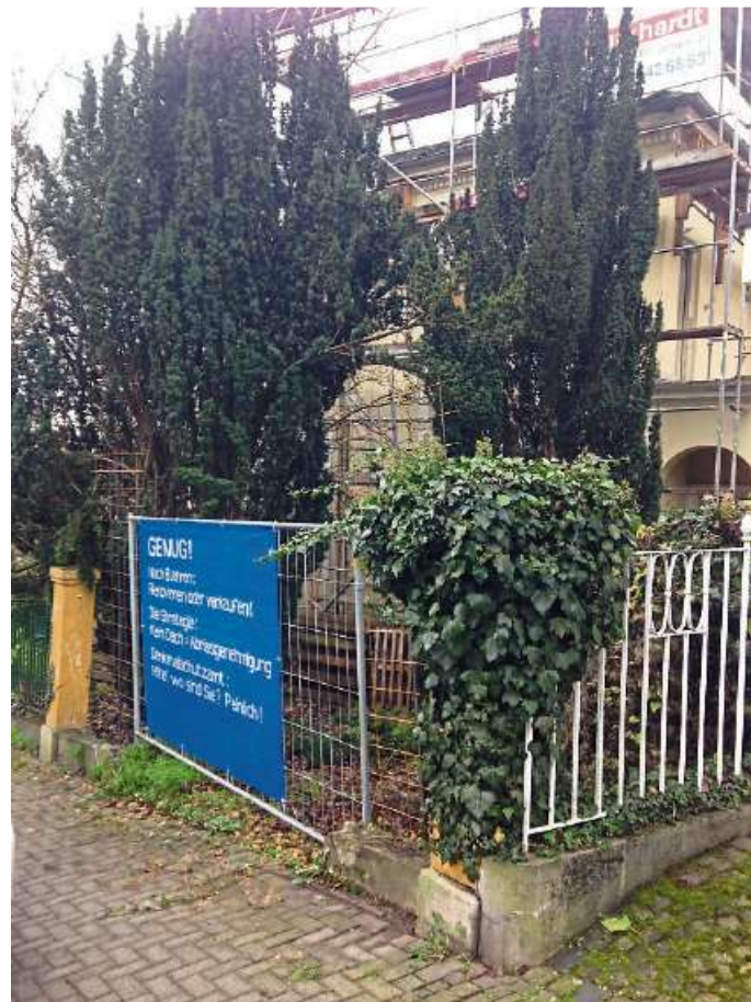
Die kopflose Villa im Dornröschenschlaf. Seit Mai 2014 ist an dem denkmalgeschützten Gebäude das Dach entfernt.
